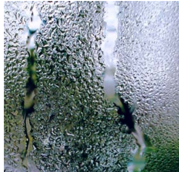
Abb. 4: An Fenstern und Spiegeln gut zu sehen: Kondensatbildung an kalten Flächen. Das Gleiche passiert an kalten Wandflächen - meistens unsichtbar!
