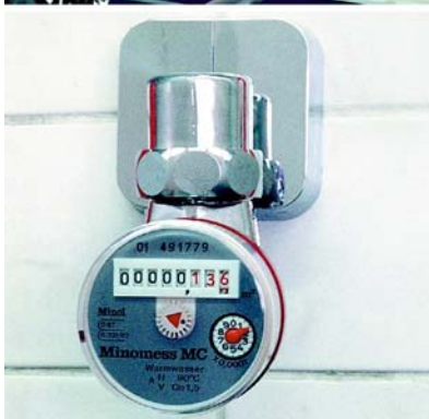
Abb. 4: Die Modernisierung der alten Warmwasserkostenverteiler ist einfach und ohne Eingriff an der Leitungsführung möglich. Dazu wird lediglich der ursprünglicher Verteiler demontiert. Mit einem speziellen Bohrverfahren wird das vorhandene Venturi-T-Stück dann für die Montage des geeichten Warmwasserzählers MINOCONTROL vorbereitet.
