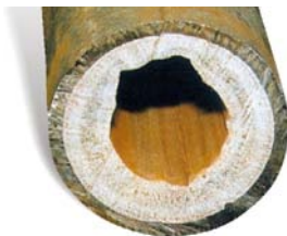
Abb. 2: So sieht eine Warmwasserleitung nach mehreren Jahren aus, wenn keine besonderen Maßnahmen ergriffen wurden, um Verkalkung zu verhindern.
