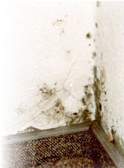
Abb. 5: Wegen der geringeren Dichte von tragenden Böden und Decken entstehen besonders dort Wärmebrücken. Bei fehlender Belüftung bildet sich zuerst Feuchtigkeit und dann Schimmel.
